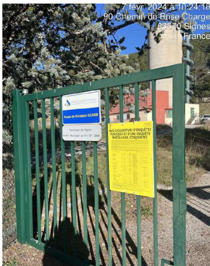
Poste de livraison Signes
